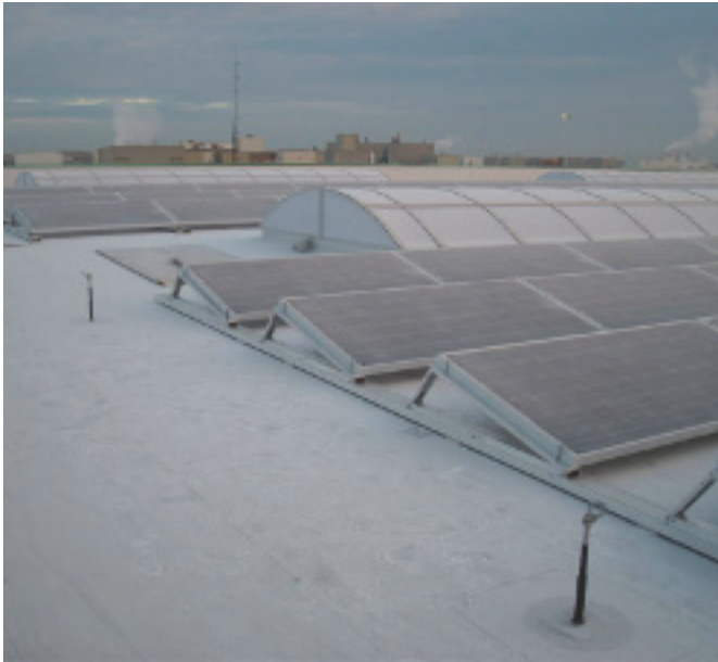
Installatie van zonnepanelen op de opslagplaatsen van DP World Breakbulk in Antwerpen, door Dexia gefinancierd in het kader van zijn Dexia Energy Line – Hernieuwbare energie.
